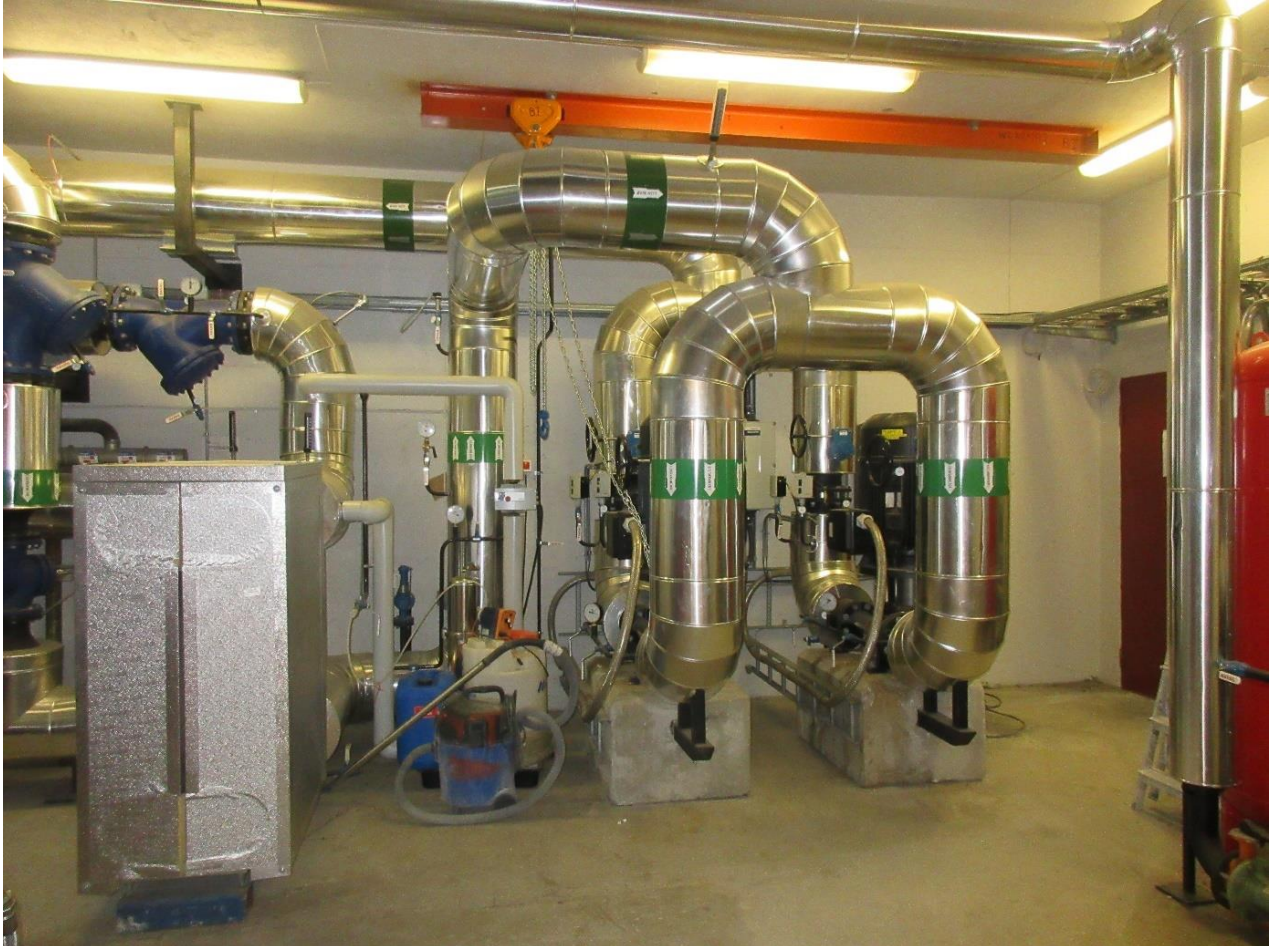
Figur 3. Varmesentral (fjernvarme) Lillehammer sykehus (foto Sykehusbygg)
