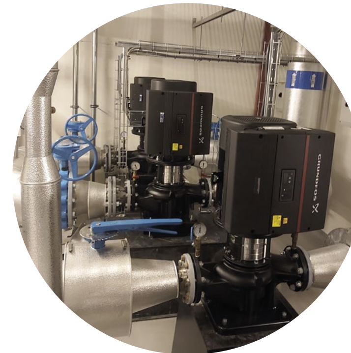
Bildet viser nye effektive pumper på St. Olavs hospital – Akutt, hjerte og lungesenteret
