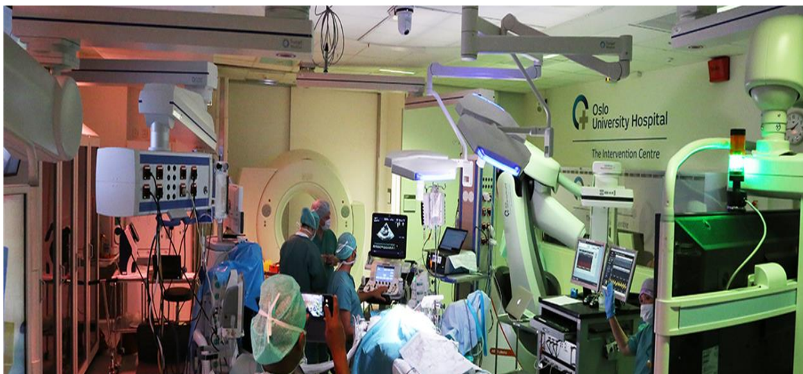
Bilde 9.10 Hybrid operasjonsstue ved Oslo universitetssykehus; operasjonsstue med CT (Foto: OUS)
