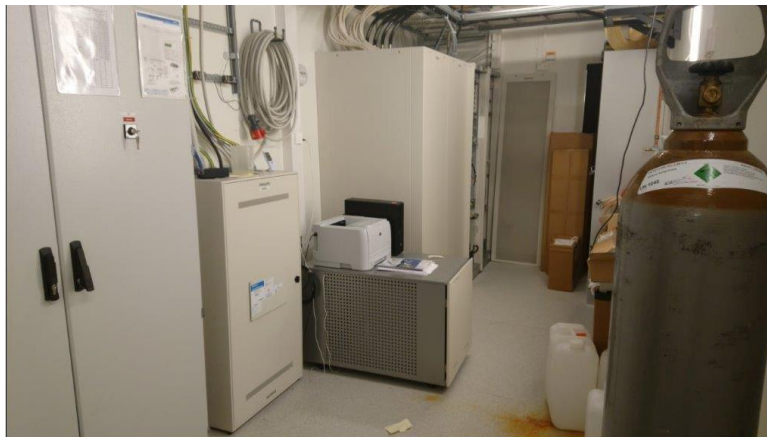
Bilde 13.3 Eksempel på teknisk rom. (Kilde: Narvik sykehus)
