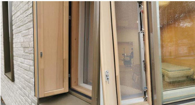
Figur 4.15 Lufteluker i sengerom. Til venstre: Manuell åpning av lufteluke. Til høyre: Motorstyrt lufteluke. Bilde: St. Olav Eiendom
