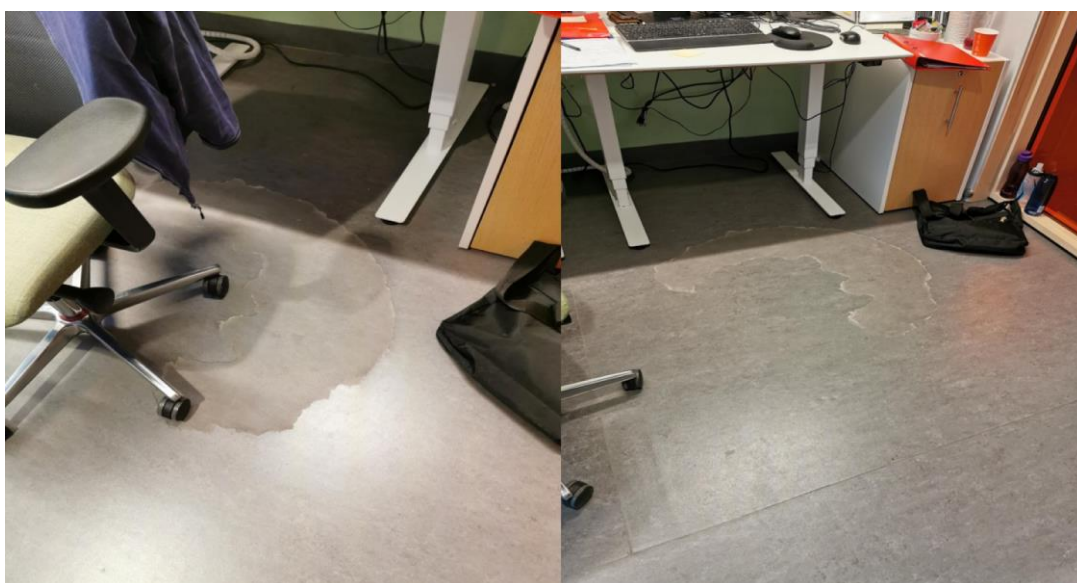
Figur 4.22 Arbeidsplasser med slitt gulvbelegg. Kilde: St. Olav Eiendom
