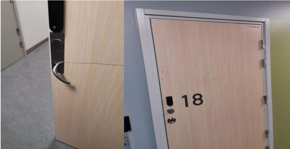
Figur 4.20 Sengeromsdør. Ødelagt dør til venstre. Bilde: St. Olav Eiendom
