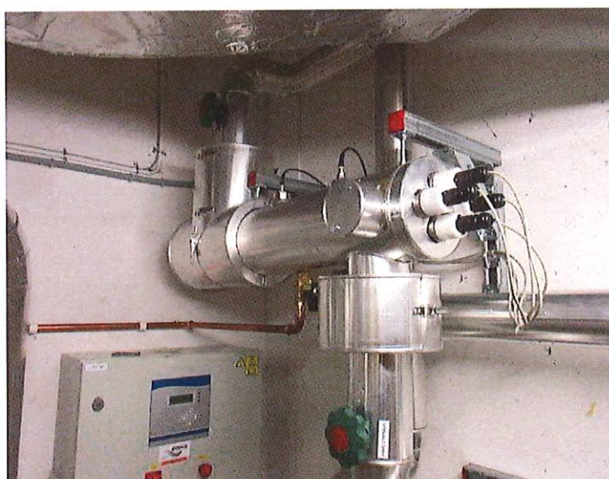
Bilde 6 Inntak på vann med UV behandling. Foto Sykehusbygg.
