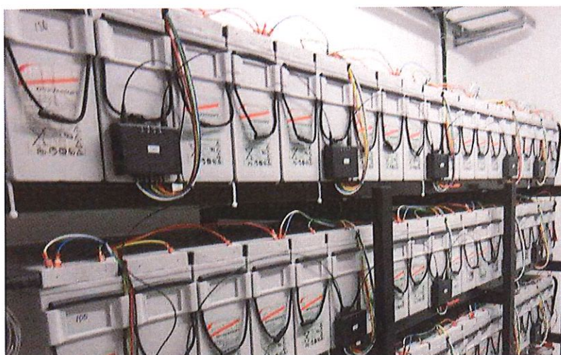
Bilde 12. Batterirom (UPS anlegg) Foto Sykehusbygg
