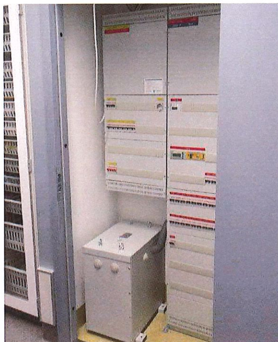
Bilde 10 Skilletrafo/underfordeling gruppe 2 rom. Foto Sykehusbygg
