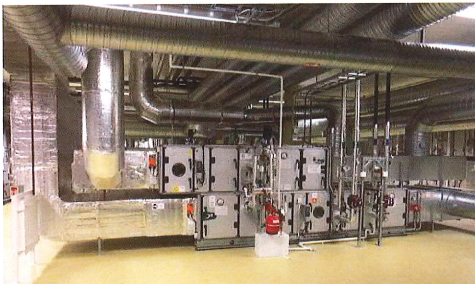
Bilde 5 Ventilasjonsaggregat til operasjon 3 (36.527) Foto Sykehusbygg
