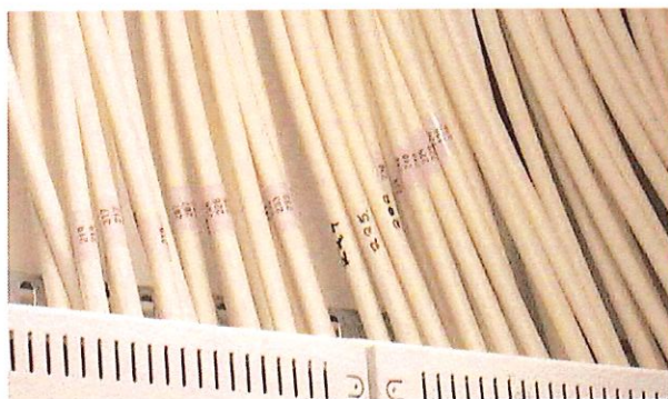
Bilde 8 Flere kabelrør er umerket (skal merkes ifølge konkurransebilag A-fløya). Foto Sykehusbygg.
