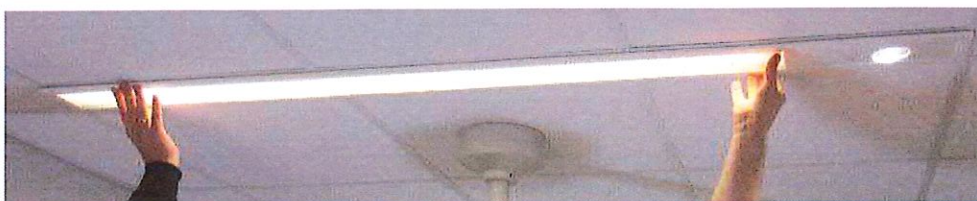
Bilde 11 Lysarmaturer beregnet for gipsplatehimling er benyttet i systemhimling. Foto Sykehusbygg
