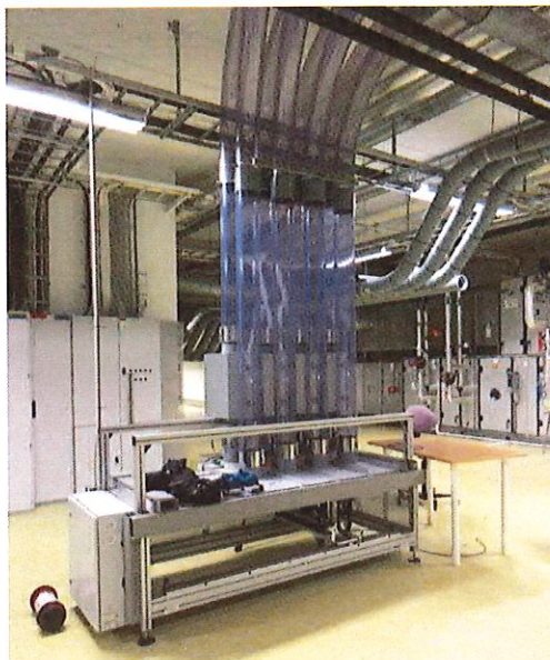
Bilde 7 viser rørpostsentralen. Foto Sykehusbygg
