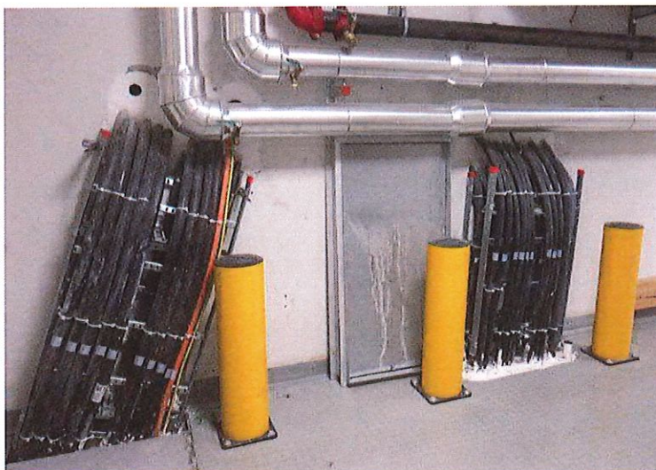
Bilde 9. Kabler fra hovedtavle med prioritert/uprioritert og UPS strøm Foto Sykehusbygg.
