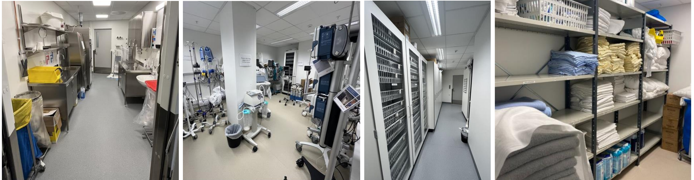
Fra venstre: Desinfeksjonsrom, utstyrslager, lager for forbruksvarer og tøylager i fløy B
