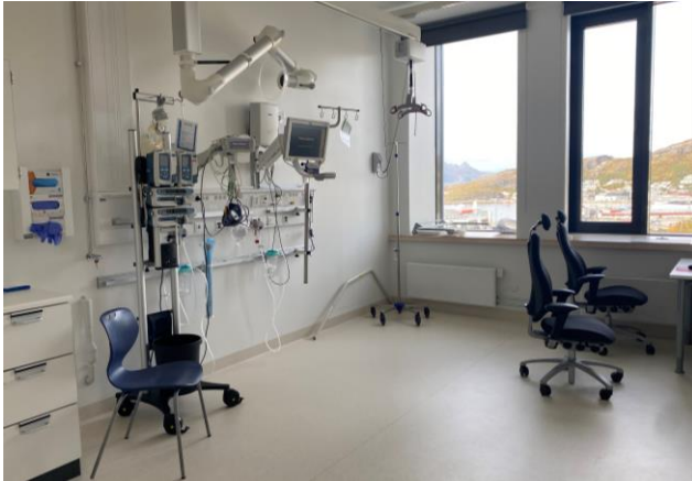
Sengerom i fløy A, overvåking
