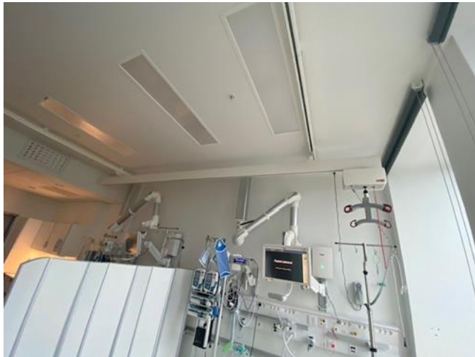
Sengerom i fløy A, overvåking. Pasientløfter på tvers av sengeplassene
